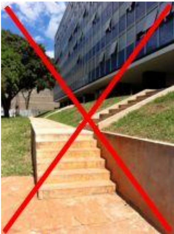
Figura 25 – Escada em área pública sem atender padrões de acessibilidade.
